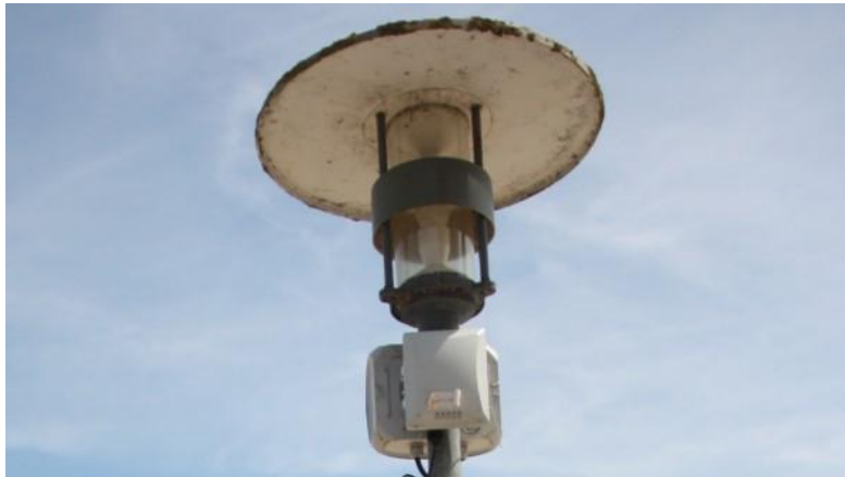
Die Access-Points sind unauffällig an den Laternen installiert
