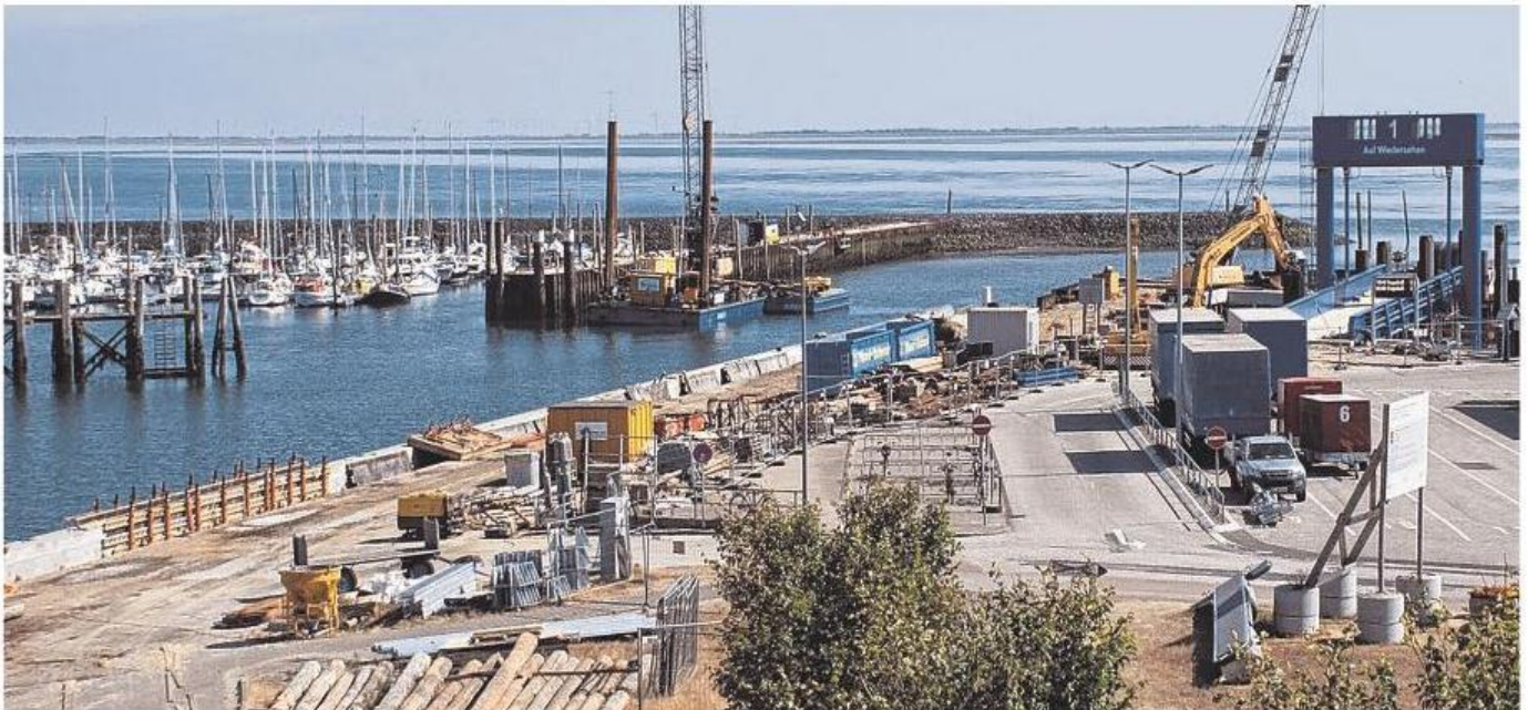
Derzeit werden die Umrundung der neuen Kaianlage betoniert und die Strom- und Wasserversorgung für die Schiffe gelegt.
