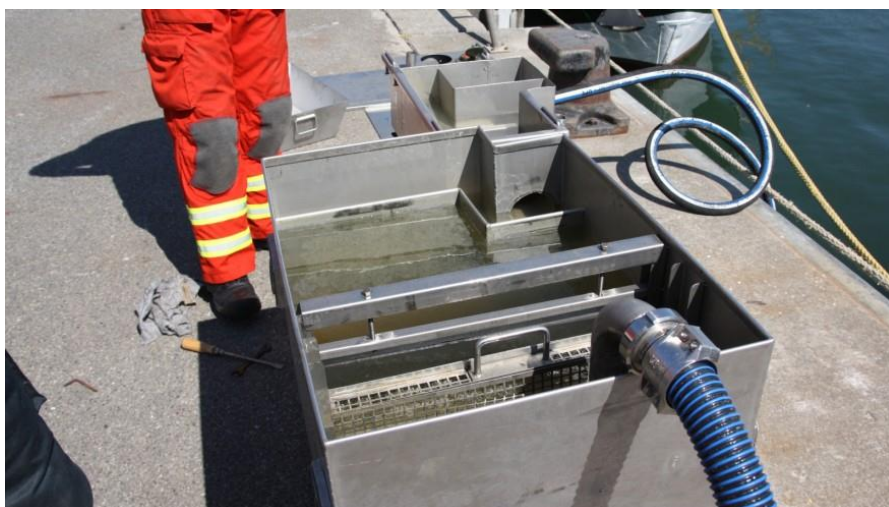
Wasser und Öl werden getrennt
