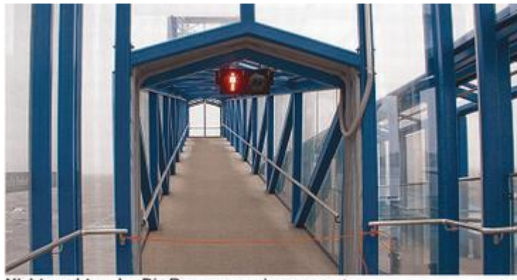
Nichts geht mehr: Die Rampen wurden gesperrt.
